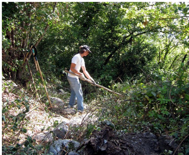
Débroussaillage en bas du rempart éboulé
